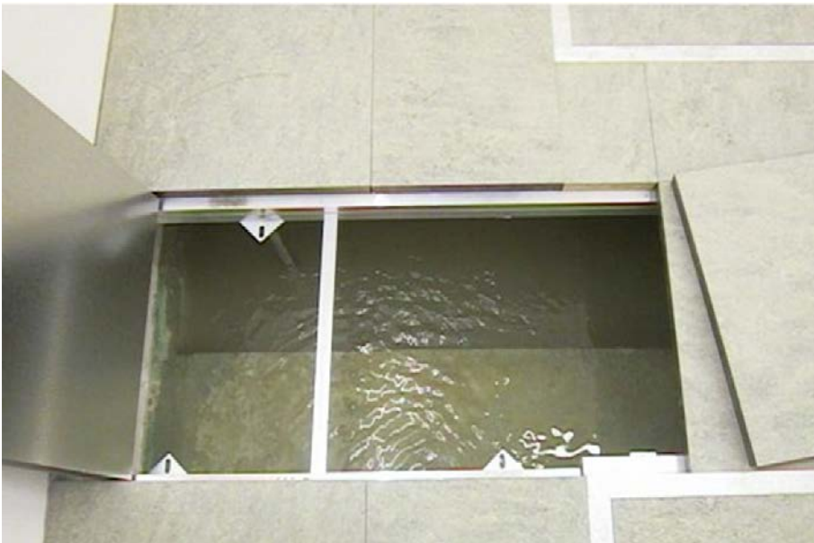
(10) Ein mit Wasser vollgelaufener Doppelboden
